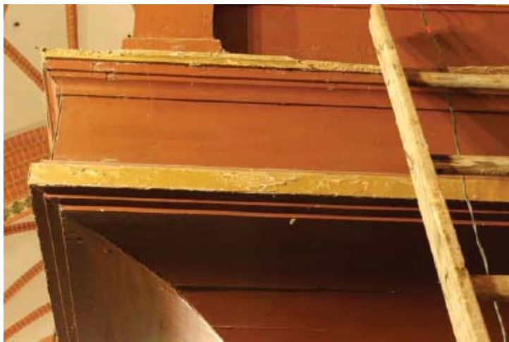
Dobre Miasto, bazylika, prospekt organowy, fragment gzymsu w cokole prospektu; widoczne ubytki drewna
