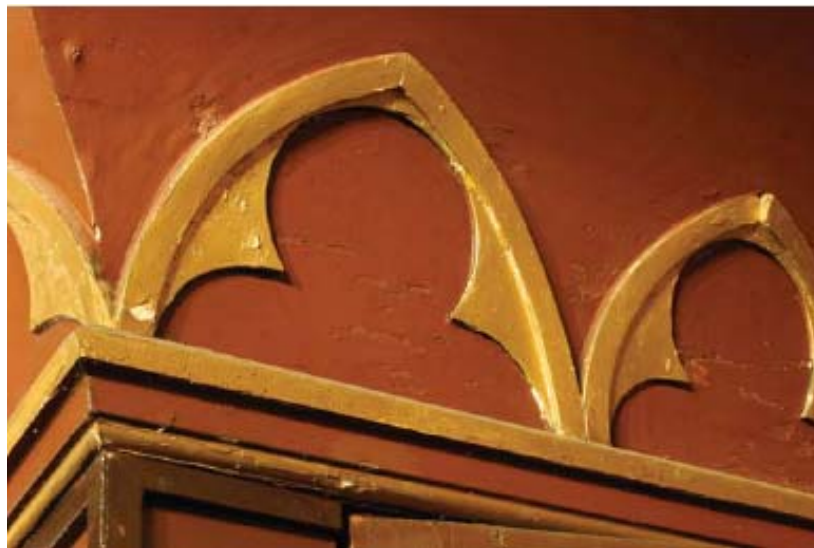
Dobre Miasto, bazylika, prospekt organowy, fragment ostrolukowego fryzu w cokole prospektu; widoczne ślady działalności owadów
