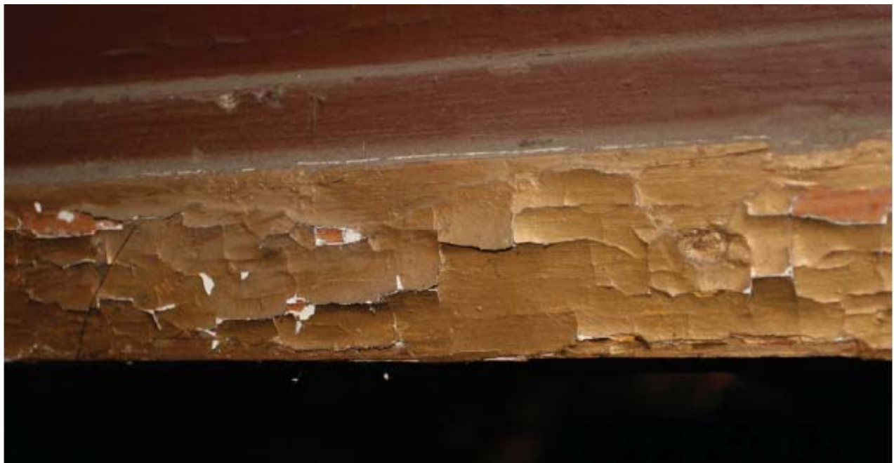
Dobre Miasto, bazylika, prospekt organowy, złocone profile, widoczne odspojenia i ubytki złoceń
